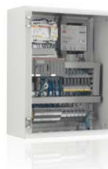
Quadri di monitoraggio precablati
